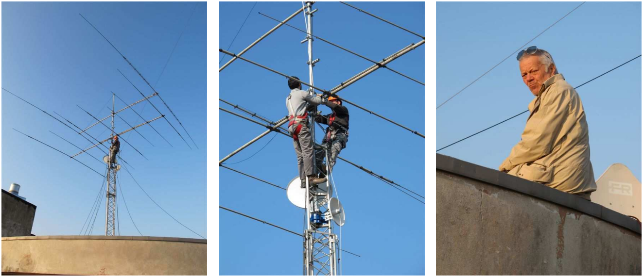
a sinistra e al centro: fasi finali dell'installazione delle antenne direttive – a destra: il direttore dei lavori, poi licenziato
